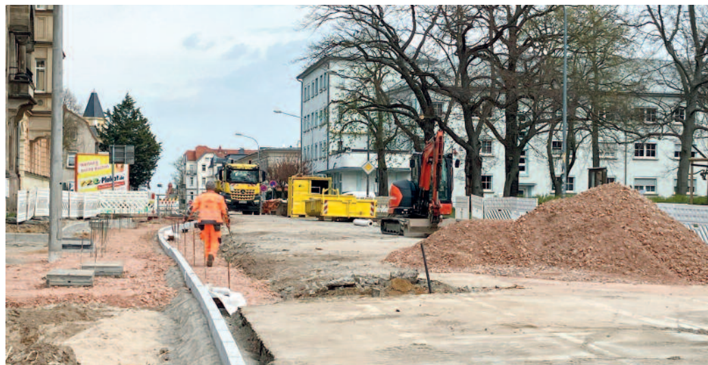
Am Ausbau der Straße sind mehrere Medienträger (u. a. für Gas, Wasser, Strom, Abwasser) beteiligt. U.P.
