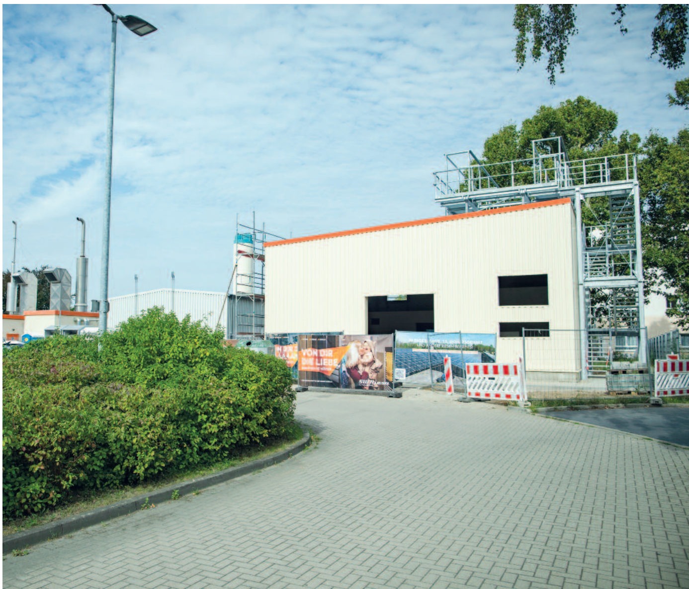
Modernisierungsschritt für Riesa: Das Heizkraftwerk auf der August-Bebel-Straße erhält eine umweltfreundliche Luft-Wärme-Pumpe und u. a. leistungsstarke Kesselanlagen. Foto: M. Seifert
