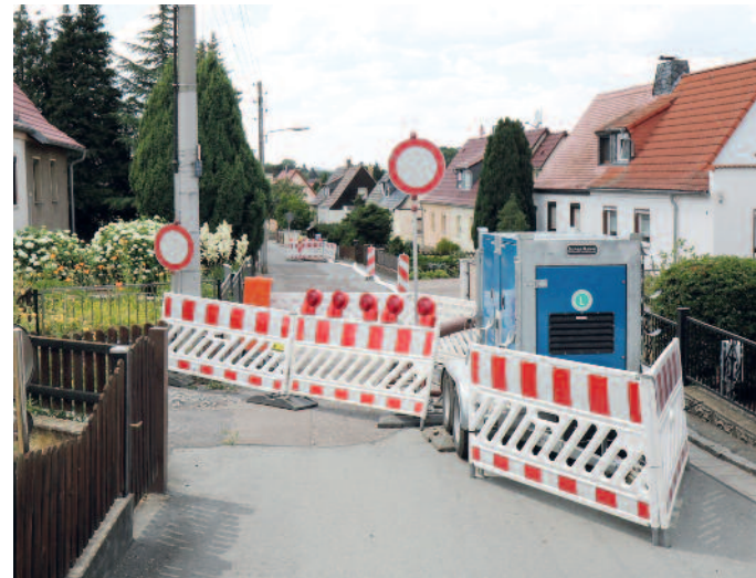
Seit einigen Wochen wird das Abwasser einiger Häuser der Rosa-Luxemburg-Straße mit einer provisorischen Lösung entsorgt. Foto: U.P.
