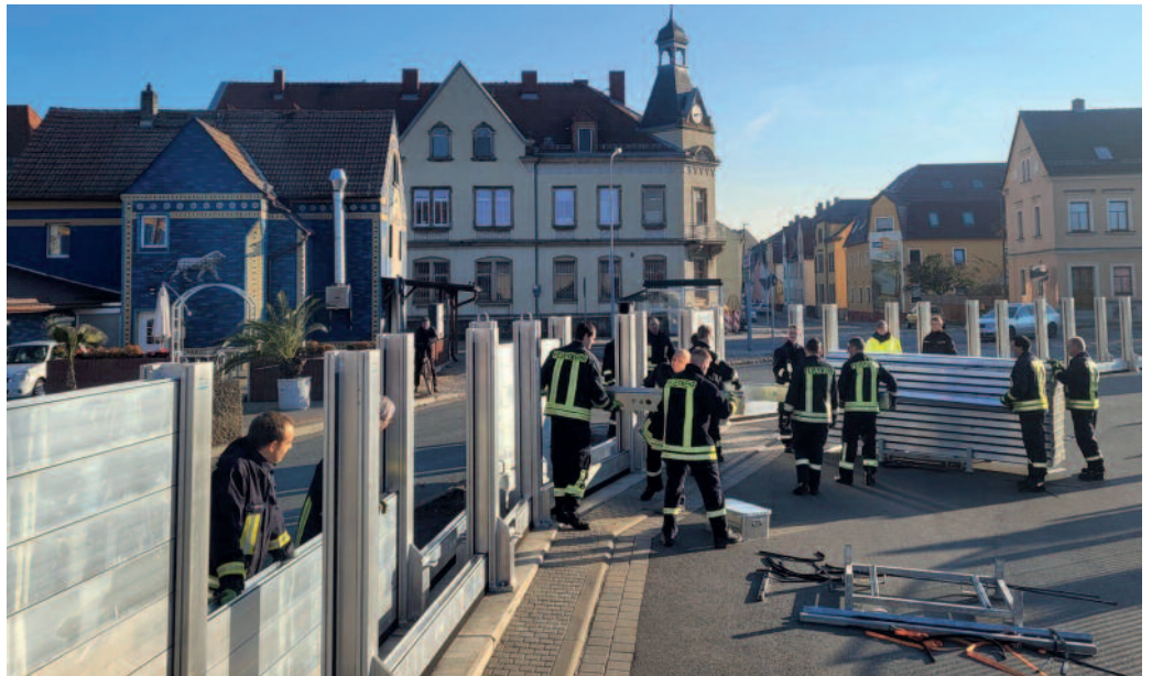
Erstmals wurde die mobile Hochwasserschutzanlage an der Strehlaer Straße im Abzweig zum Mühlweg komplett aufgebaut. Sie soll beim drohenden Überlaufen des Hafenbeckens zum Einsatz kommen. Foto: Feuerwehr
