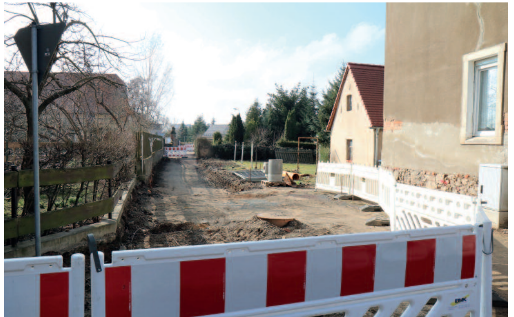
Die Bauarbeiten an der Kirchstraße und hier am Dammweg sollen rasch fortgesetzt werden. Foto: U.P.
