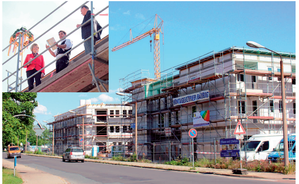
An der Alleestraße nimmt das Begegnungszentrum Gestalt an. Die Genossenschaftsvorstände Kerstin Kluge und Hagen Nickol sowie Zimmerermeister Marco Steinbach vollzogen das Richtfestritual. Fotos: U.P.
