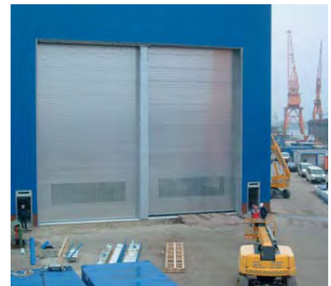
Ein „Leckerbissen“ aus dem Hause Nowotnik ist das 16 m x 13,50 m große Tor in einer Werfthalle der Thyssen Krupp Nordseewerke in Emden. Foto: Nowotnik
