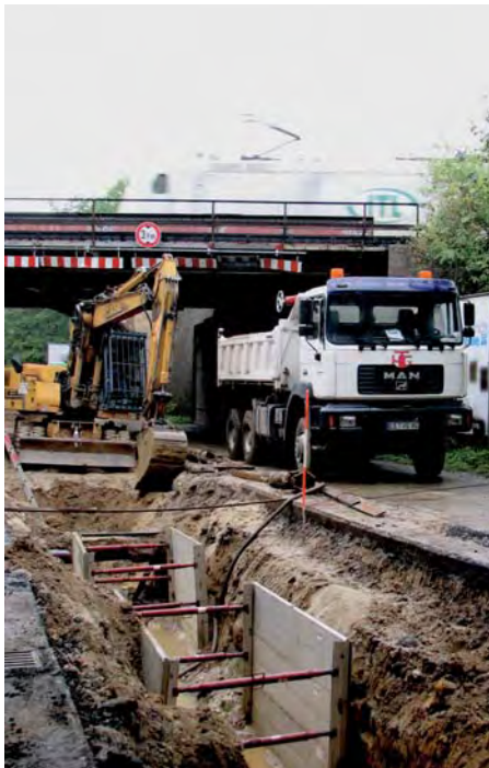
Unter den Eisenbahnbrücken im Zuge der Rostocker Straße werden derzeit Gas- und Wasserleitungen ausgetauscht.
