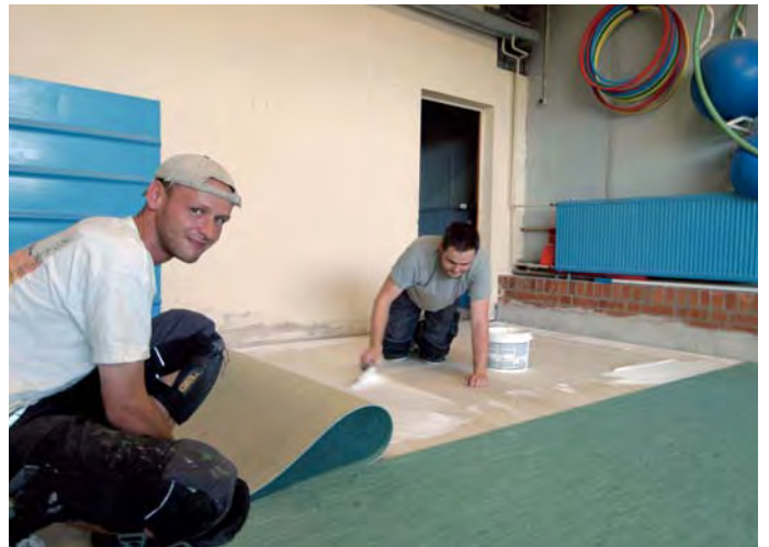
Jörn Kays (l.) und Kai Metzler von der Firma Hoppe Sportbodenbau verlegen den neuen Fußboden in der Turnhalle.
