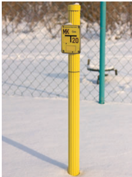
Das moderne Erdgasnetz Riesas versorgt rund 6.000 Kunden sicher mit dem umweltfreundlichen Energieträger. Fotos: M. Lorenz
