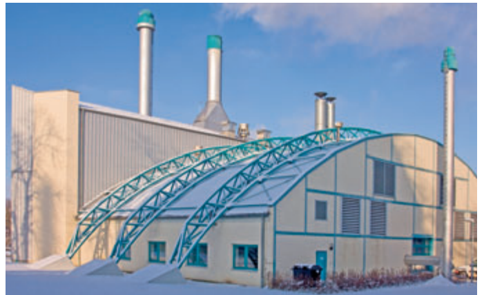
Das Heizkraftwerk Merzdorf liefert auch bei frostigen Temperaturen zuverlässig Wärme ins Wohngebiet Merzdorf. Zudem erzeugt es dank umweltfreundlicher Kraft-Wärme-Kopplung Strom.
